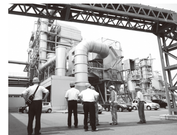
バイオマス発電設備
